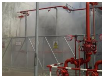
防火システム
