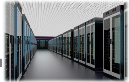
データセンター機器間配線
