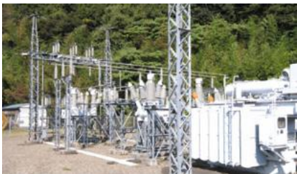
変電所・発電所
