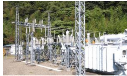
変電所・発電所
